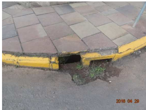
Figura 64: Boca de lobo localizada no entroncamento das ruas Itália e Garibaldi.
