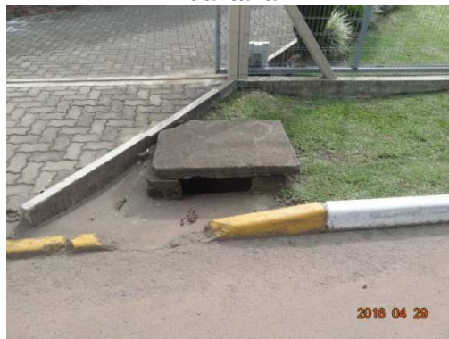
Figura 62: Caixa de inspeção localizada na rua Itália.
