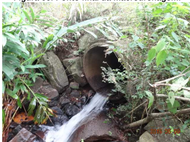
Figura 66: Ponto final da macrodrenagem.
