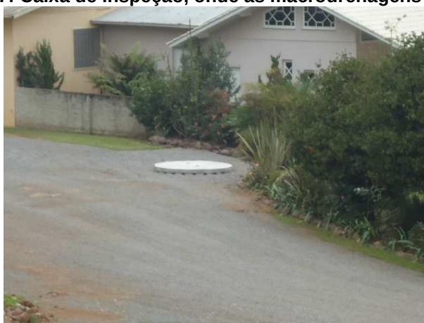
Figura 67: Caixa de inspeção, onde as macrodrenagens se unem.
